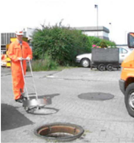
Verfahren der Schachteinstieghilfe vom Wartungsfahrzeug zum Einstieg.
