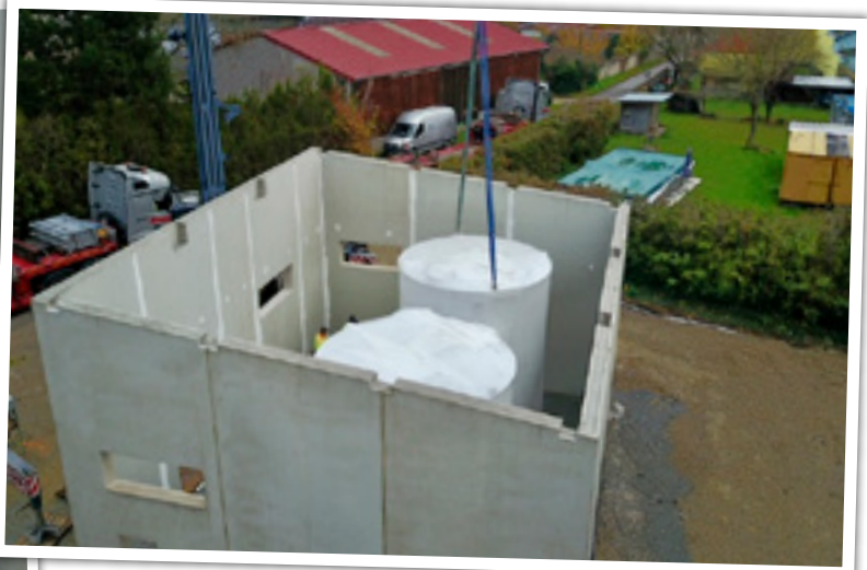
Hochbehälter Engelhartstetten – Baujahr 2022
