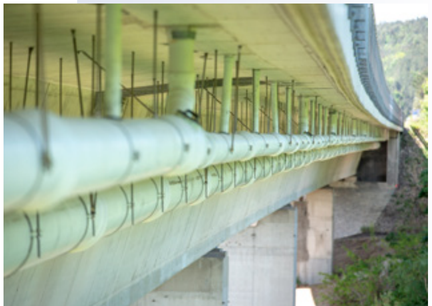
Brückenentwässerung S31 . Knoten Mattersburg, Österreich
